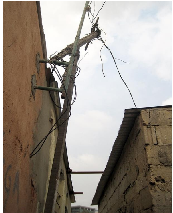
Fig. 118 | A rede elétrica é na sua maioria através de puxadas perigosas
